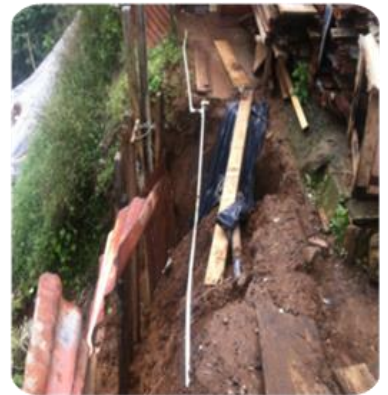
Propiedad afectada por fuertes lluvias en San Jerónimo de Naranjo
