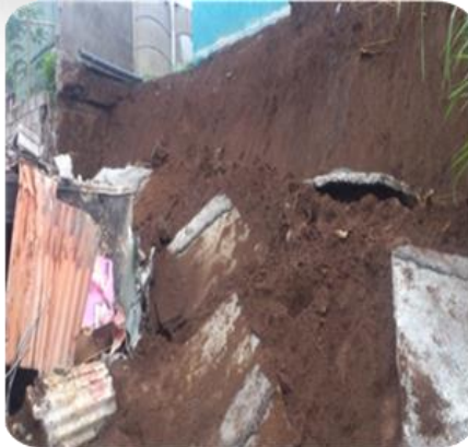
Propiedad afectada por deslizamiento y colapso de muro en Rosario de Naranjo
