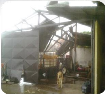
Propiedad afectada por fuertes vientos en Lourdes
