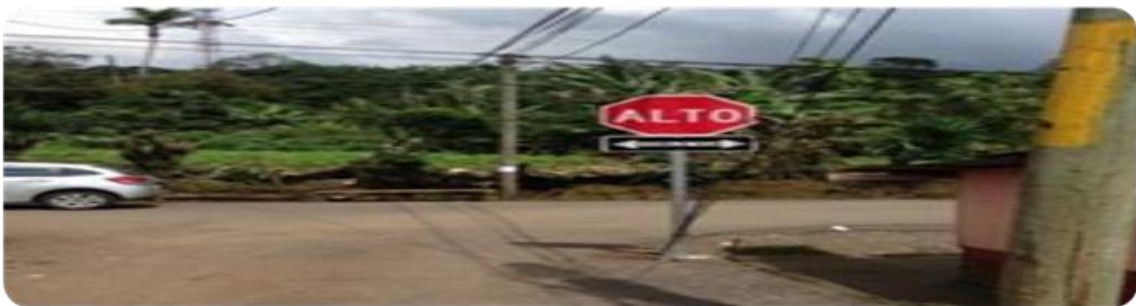
Se colocaron 2 Señales de Alto con Flechas Complementarias
