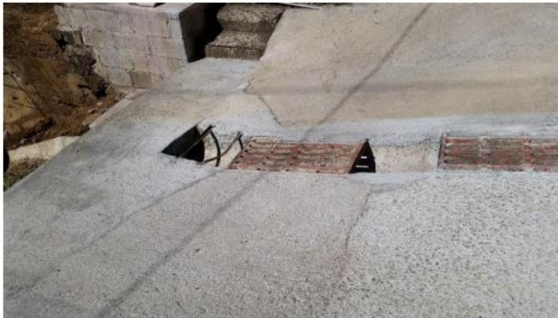
Arreglo de sistema de alcantarillado, cuneteado, rampa -100 Sur capilla Barrio el Carmen
