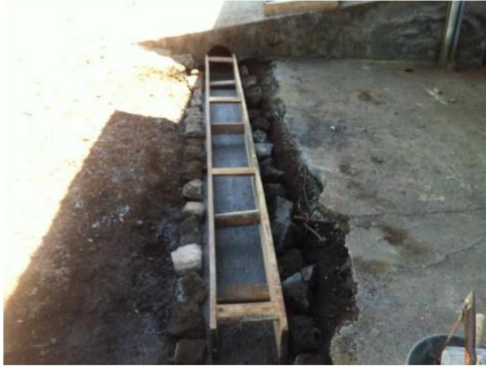
Barrio María Auxiliadora- Caño Revestido -rampa -entrada Ciudadela Marín (antes)
