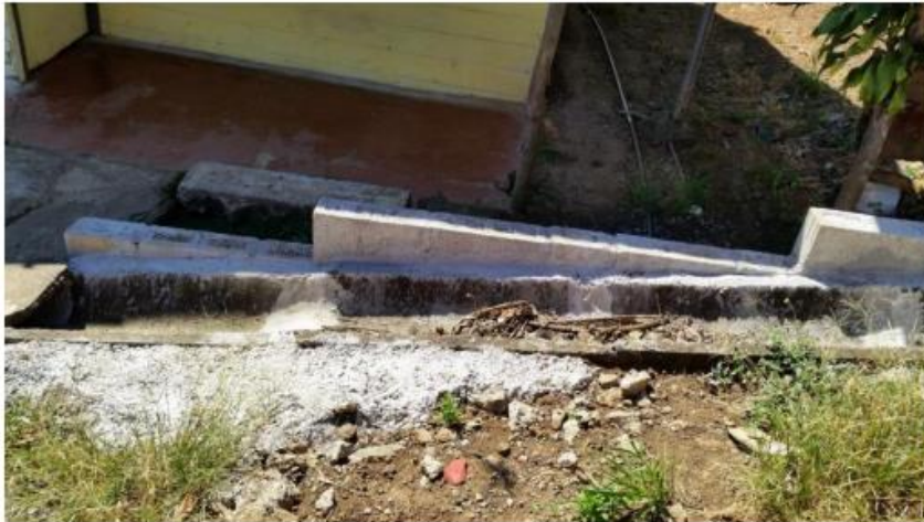
Arreglo de cunetas en el sector taller cubero-con construcción de muro de soporte
