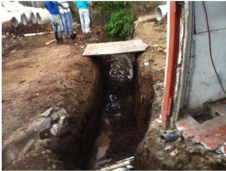
Barrio el Carmen –Segunda entrada- IMAS (alcantarillado y cuneteado -en ejecución) para recoger aguas servidas y pluviales
