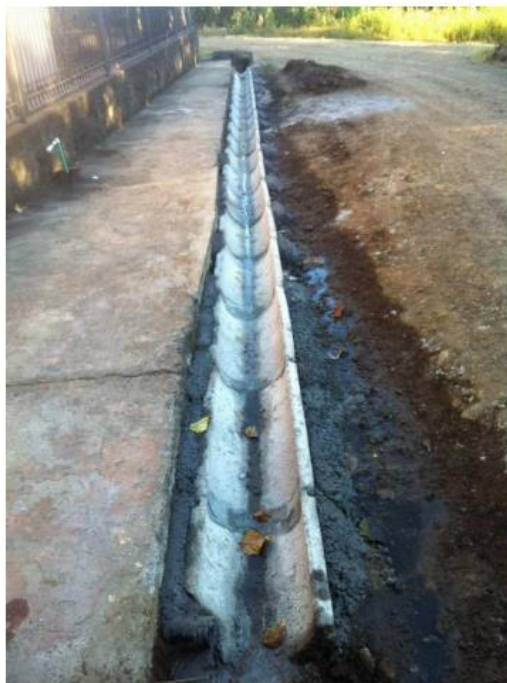
Cuneteado – Barrio el Carmen –Frente terreno CCSS-(Saneamiento de aguas servidas Empozadas)
