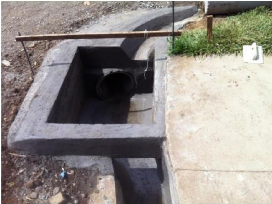
Cajas de registro urbanización Coopenaranjo (en ejecución)
