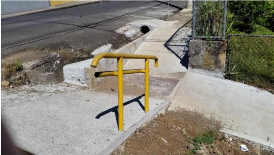
Eliminación de Gradadas por rampa –rampas externas hacia la carretera, una con pasamanos Esquina frente al taller Sandoval.
