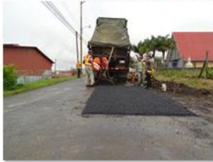
Bacheo El Muro-Cementerio San Juan
